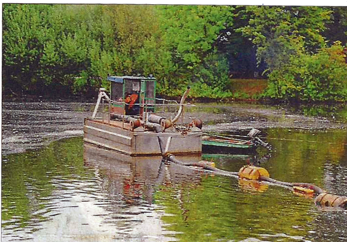
Der Saugbagger: Er war in den vergangenen Wochen am Bürgerfelder Teich im Einsatz.
